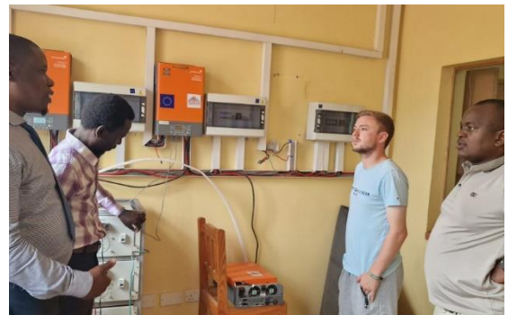
Menard und Tim vor einer Solaranlage
